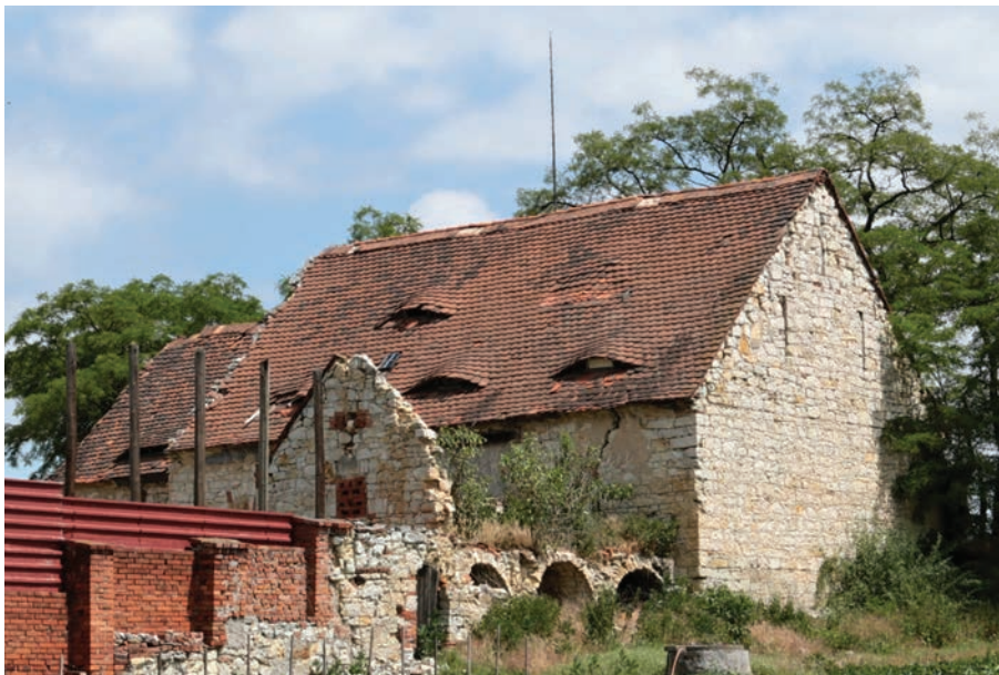
3.8 Vikýře ve tvaru volských ok otevírají střešní valbu ve dvou úrovních na pasivní sušárně v obci Dubčany, p. č. 32. Střešní valbu sousedního objektu otvírá pásový vikýř, foto: Roman Švec 2018.
