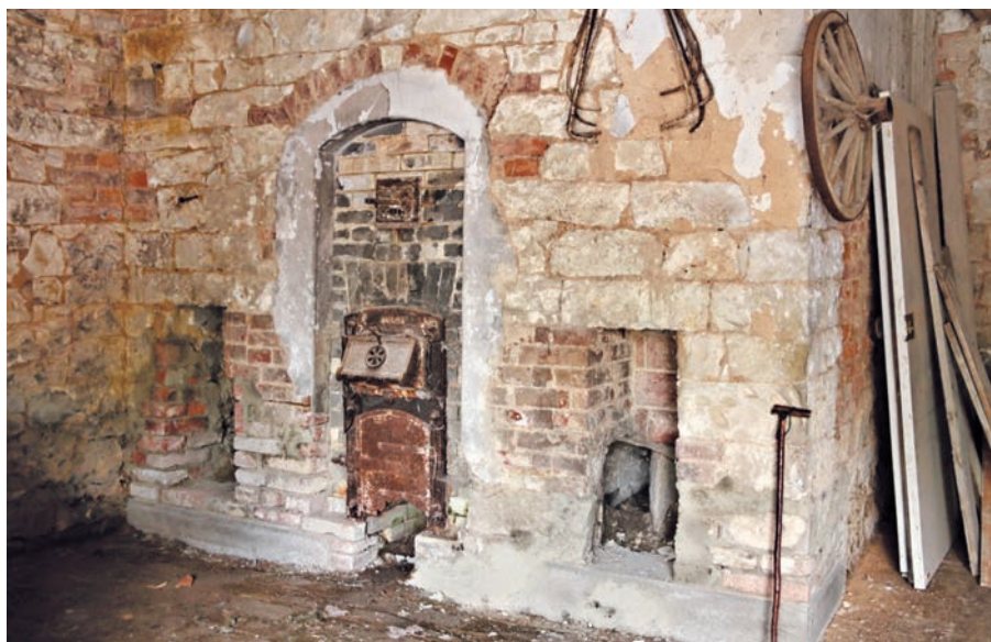
3.15 Topeniště hvozdu, sušárna chmele v obci Dubčany, p. č. 3, foto: Roman Švec 2017.
