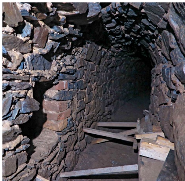
Obr. 14. Plasy, klášter, štola Q. Místo dodatečného vložení štoly Q2 (vlevo), rovněž pokračuje Q1. Pohled od severozápadu. (Foto T. Karel, 2018)
