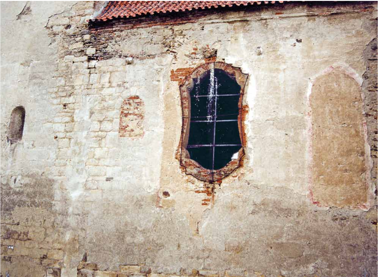
Obr. 2. Horšov (okr. Domažlice), kostel Všech svatých. Pohled na část jižního průčelí lodi. Je dobře patrné například umístění barokního kasulového okna na místě vysokého gotického okna, zazdžené románské okno (vlevo) a zazdžené gotické okno (docela vpravo), románské kvádrové zdivo, románské okno prostoru v patře pod koutovou věží (původně na tribunu; docela vlevo) a torza dvou konzol v úrovni okapu průčelí románské svatyně. (Foto J. Bradna, 2001)
