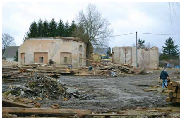
Obr. 12. Nahý Újezdec, hospodářský dvůr čp. 10 během demolicce. Uprostřed snímku je vidět polygonální část stodoly, kde býval žentour. (Fotoarchiv Národního památkového ústavu, ú. o. p. v Plzni, foto S. Plešmíd, 5. 2. 2013)
