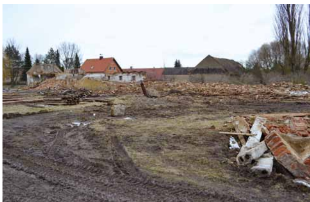
Obr. 11. Nahý Újezdec, hospodářský dvůr čp. 10 během demolicce. V pozadí jsou pozůstatky budovy, která obsahovala obytnou část a stáje. (Fotoarchiv Národního památkového ústavu, ú. o. p. v Plzni, foto S. Plešmíd, 5. 2. 2013)
