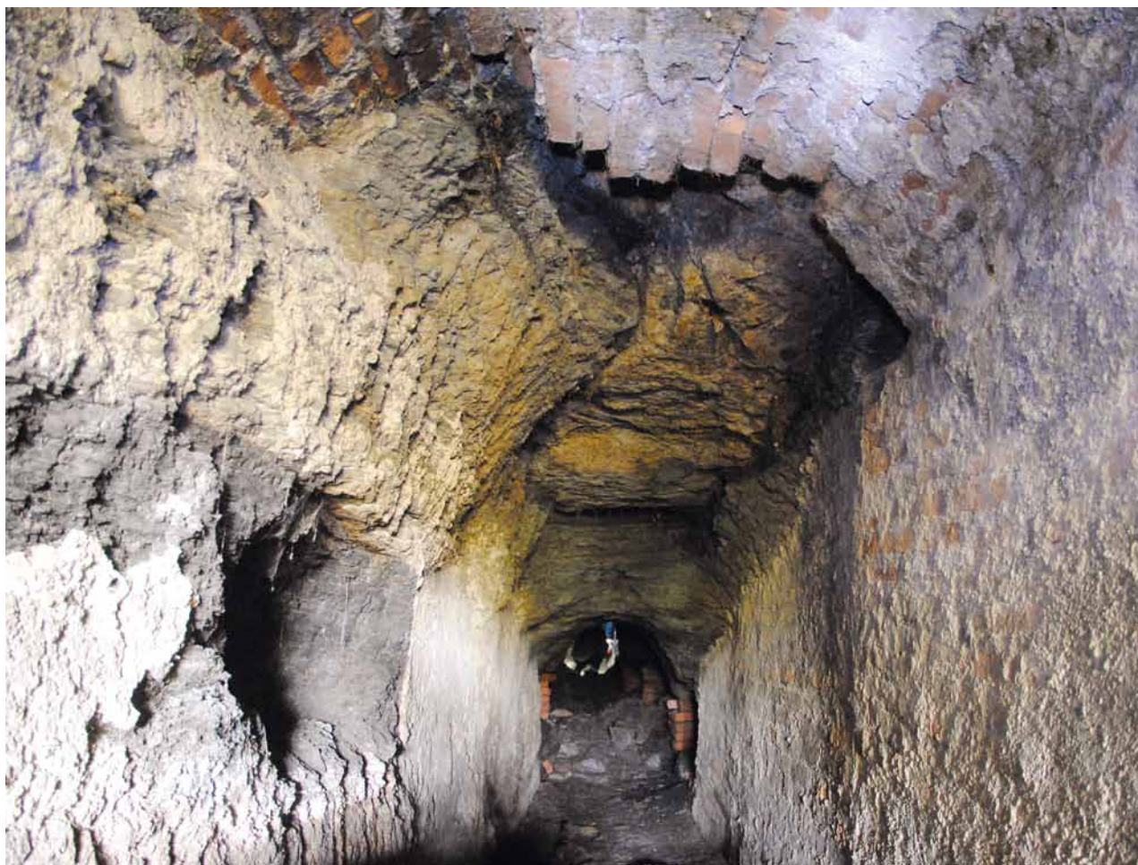
Obr. 8. Plzeň, štola U Všech svatých. Vstupní prostor na jižním konci štoly. Na snímku vlevo je vidět částečně odtěženou žílu černého uhlí. Cihlová klenba je narušena. (Foto M. Strejc, 2012)
