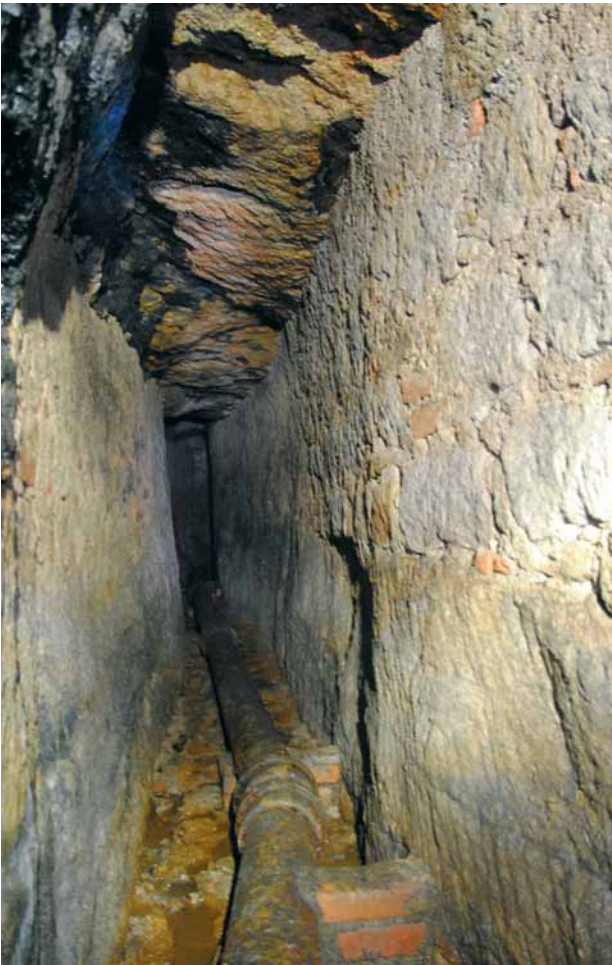
Obr. 9. Plzeň, štola U Všech svatých, jižní úsek. Lokální úpravy ze smíšeného zdiva, žíla černého uhlí je vidět nahoře u stropu. (Foto M. Strejc, 2012)
