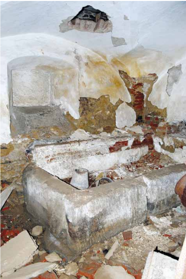
Obr. 9. Hlavňovice, areál zámku a poplužního dvora. Sladovna, náduvník v humně a nad ním sypací otvor, zvětšený destrukcemi. (Foto J. Anderle, 2008)
