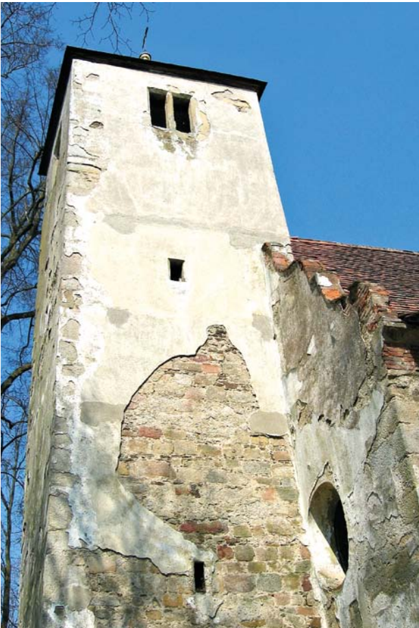
Obr. 12. Bukovec, kostel Nanebevzetí Panny Marie. Jižní pohled na horní část věže. Stav před obnovou. (Foto Libor Sommer, 2003)
