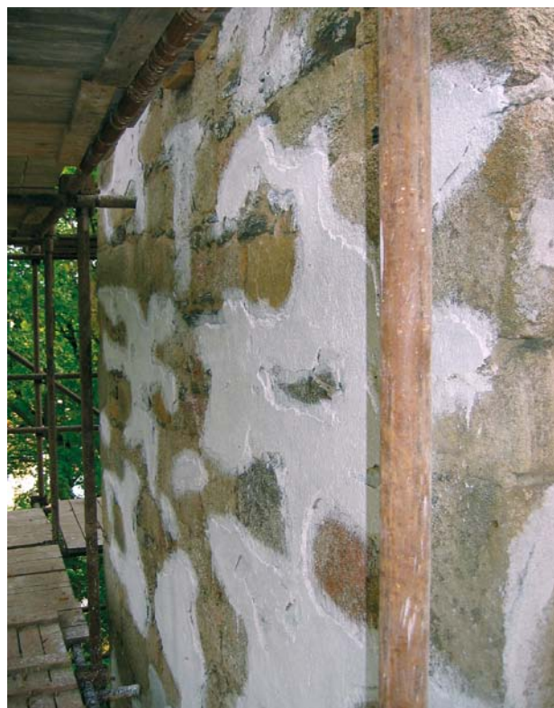
Obr. 4. Bukovec, kostel Nanebevzetí Panny Marie. Fragменты dochovaných omítek na západním průčelí během obnovy, po jejich zpevnění suspenzí hašeného vápna v alkoholu. Na snímku je vidět změna v barevnosti povrchu ošetřovaných omítek; tato změna nevádí, plánuje-li se provedení nové barevnosti. V případě požadavku na zachování původní barevnosti konsolidovaného podkladu je třeba použít vhodnou separační vrstvu, např. japonský papír. (Foto L. Sommer, 2004)
