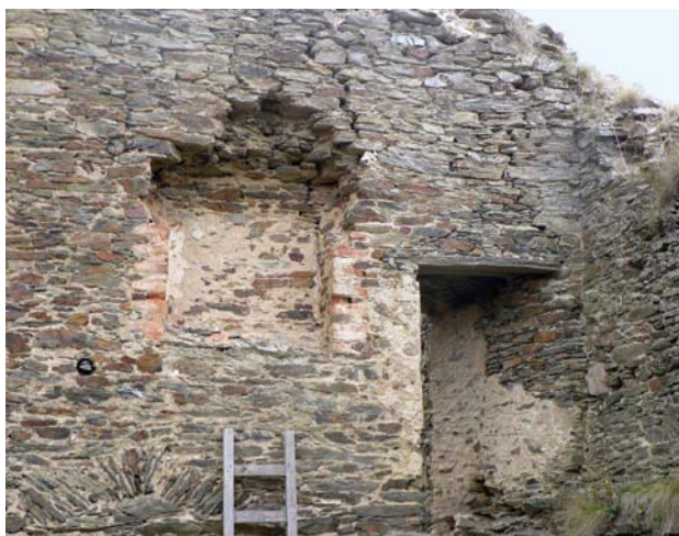
Obr. 7. Okrouhlé Hradiště, zřícenina hradu Gutštejna. Západní část jižního paláce, nika ve východní stěně. Stav před opravou. Po levé straně niky jsou ve zdivu patrné zbytky lešeňových nosníků. (Foto L. Havlovic, 2009)
