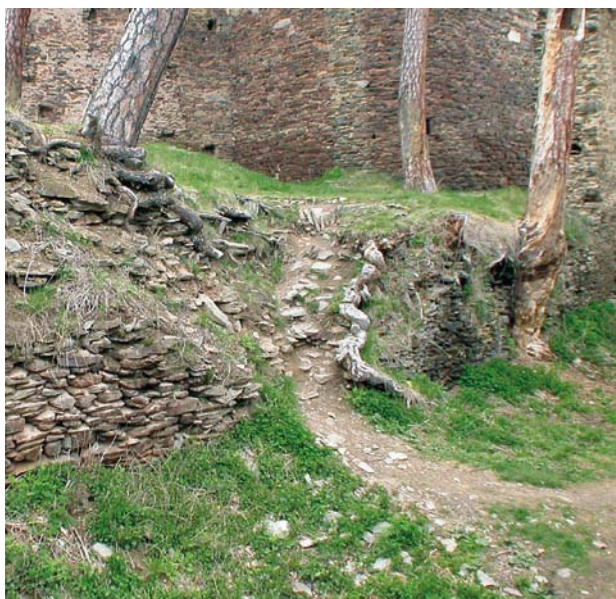
Obr. 14. Okrouhlé Hradiště, zřícenina hradu Gutštejna. Severní zeď jižního paláce, pohled od jihozápadu. Zdivo v plné šířce dochováno pouze ve spodní úrovni, výše vlevo je výrazně erodované bez líce. Uprostřed přechod z jižního paláce na horní nádvoří. (Foto P. Sokol, 2006)
