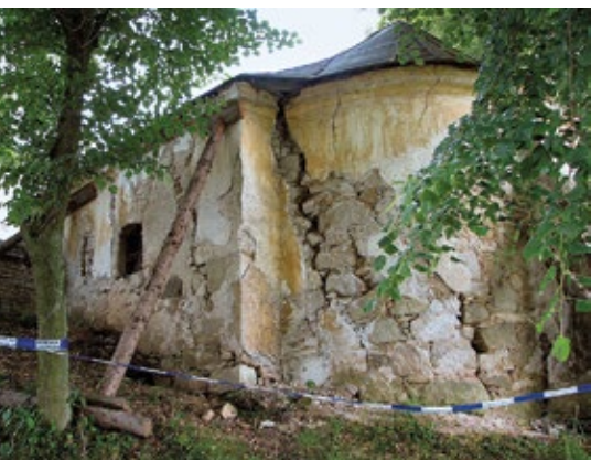
Stav před statickým zajištěním, foto Z. Stránská.
