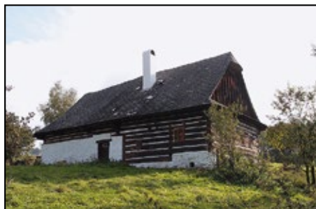
Venkovská usedlost čp. 163 v Korouhvi před výměnou krytiny a sanací krovu, foto: J. Švec
