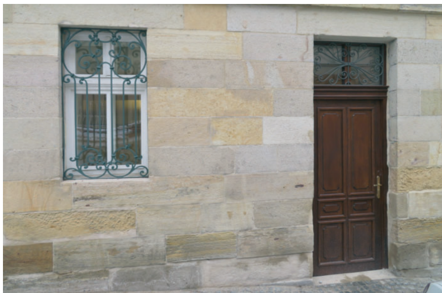
13 Olomouc, Na Hradě, č. o. 5, pohled na opravený kamenný sokl stavby s repasovanými dveřmi a novým oknem po rekonstrukci, 2019. Foto Jan Kubeš.
