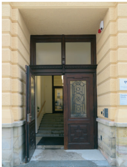
④ Olomouc, Na Hradě, č. o. 5, pohled na repasované vstupní dveře, 2019. Foto Jan Kubeš.
