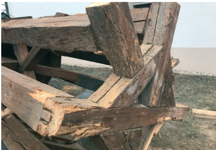
8 Horka nad Moravou, kostel sv. Mikuláše, poškozená konstrukce sanktusníkové věže, 2018. Foto Roofs. cz Group, a. s.
