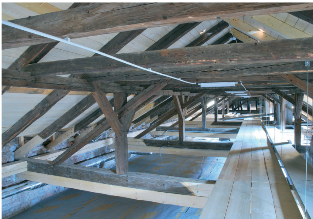
③ Čechy pod Kosířem, zámek. Konstrukce krovy nad západním křídlem po obnově. Foto Ondřej Belšík.
