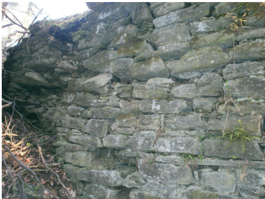
⑧ Hrad Pleče, obec Jindřichov, okr. Šumperk. Hradní jádro, zdivo jižní části hradby, detail, 2018. Foto Jitka Štáblová.
