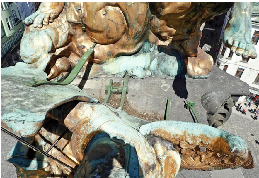
9 Olomouc, Sloup Nejsvětější Trojice, hlavice sloupu pod vrcholovým sousoším, 2017. Foto archiv NPÚ GnŘ.
