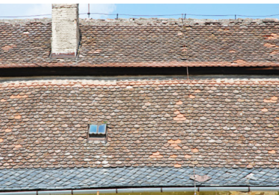
13 Plumlov, zámek, podoba střešního pláště na jižní (dvorní) střešní rovině s vykrytím okapního okraje čtvercovými šablonami břidlice, 2012. Foto Ondřej Belšík.
