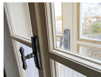
18 Olomouc, Denisova č. o. 33, detail nového deštěného okna do dvora, 2017. Foto Jan Kubeš.
