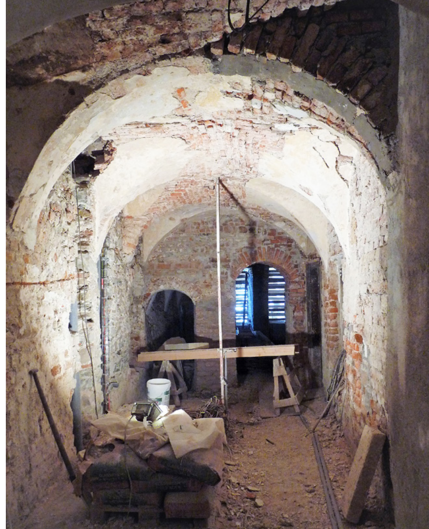
21 Olomouc, Denisova č. o. 33, ilustrativní fotografie stavu objektu v průběhu rekonstrukce v roce 2015. Pohled do klenutého průchodu směrem do dvora v přízemí, 2017. Foto Jan Kubeš.
