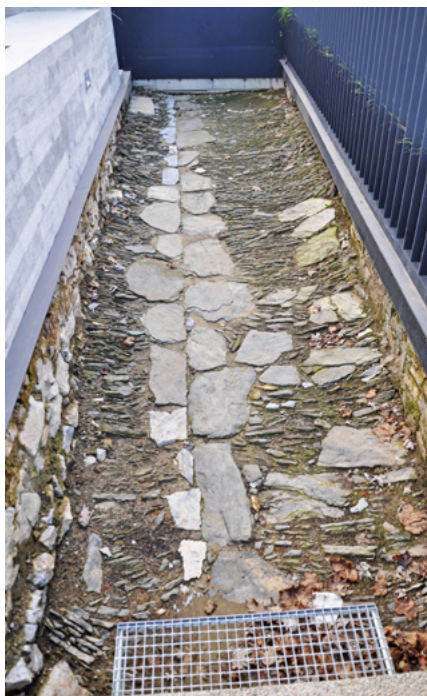
12 Přerov, náměstí Na Marku. Detail dlážděné cesty zakomponované do památníku, 2017. Foto Hana Myslivečková.
