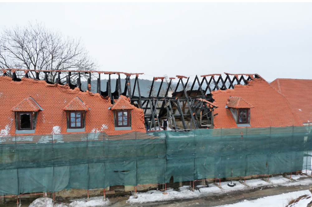
② Plumlov, zámek, požárem poničená střecha východního křídla předzámčí, 2017. Foto Ondřej Belšík.
