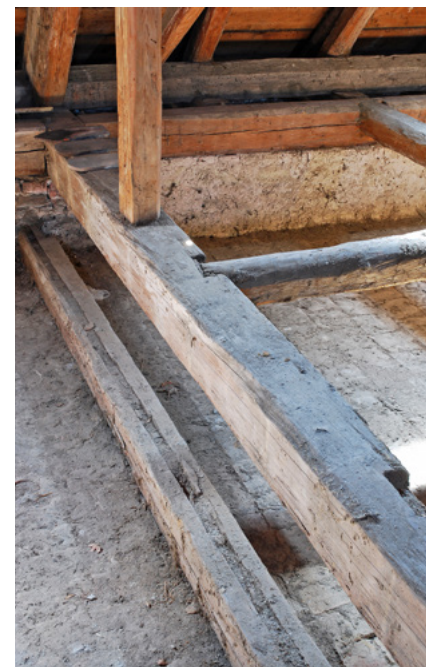
12 Plumlov, zámek, příčný prahový trám s drážkou sloužící k zapuštění vertikálně kladených fošen odstraněné dělicí příčky v pozici 2. plně příčné vazby, 2012. Foto Ondřej Belšík.
