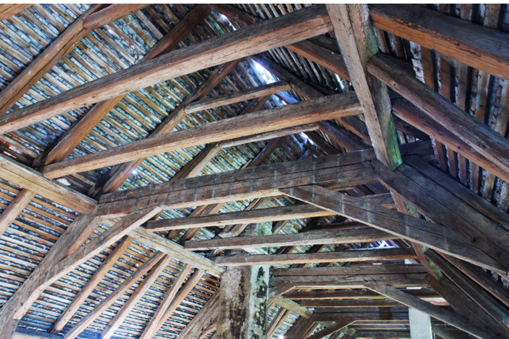
11 Plumlov, zámek, otisky rastru vertikálního kladení fošen odstraněné dělicí příčky v prostoru podkroví na východní straně prvků 2. plně příčné vazby, 2012. Foto Ondřej Belšík.
