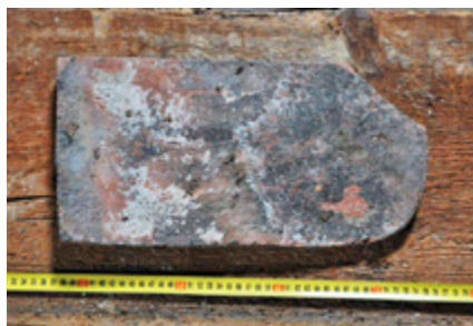
③ Fragment pálené režné segmentově zakončené bobrovky dochovaný v podkroví – lícová strana, 2014. Foto Ondřej Belšík.
