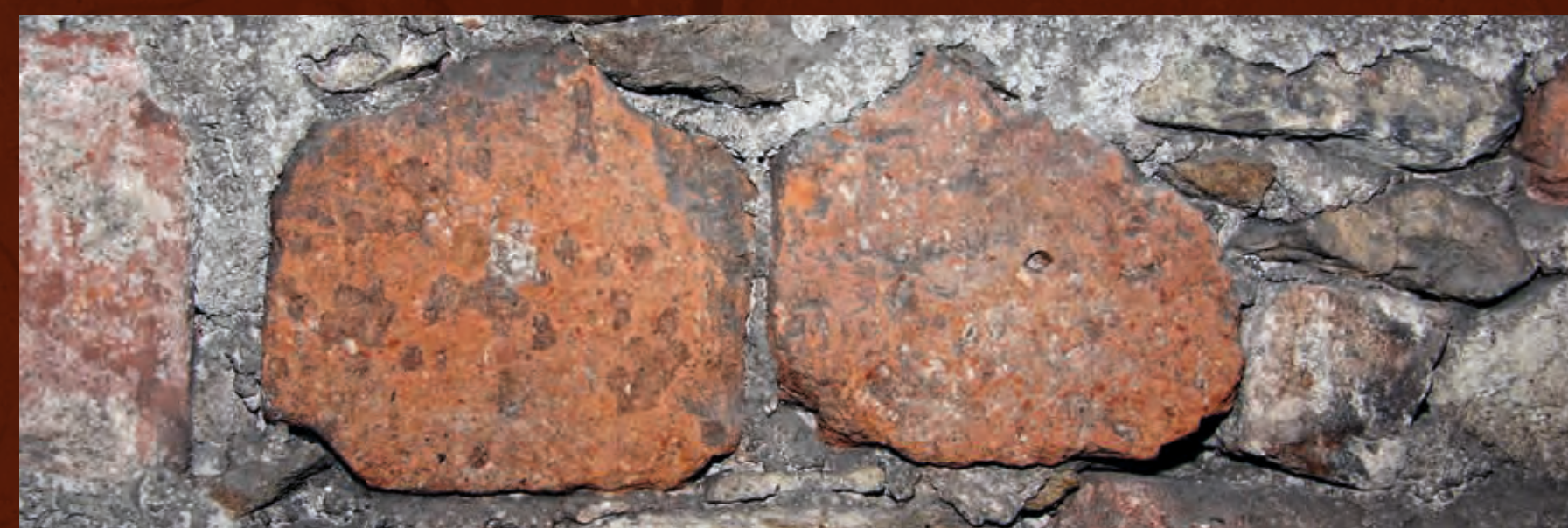
Středověké klenební tvarovky druhotně zazděné na půdě trojlodí
