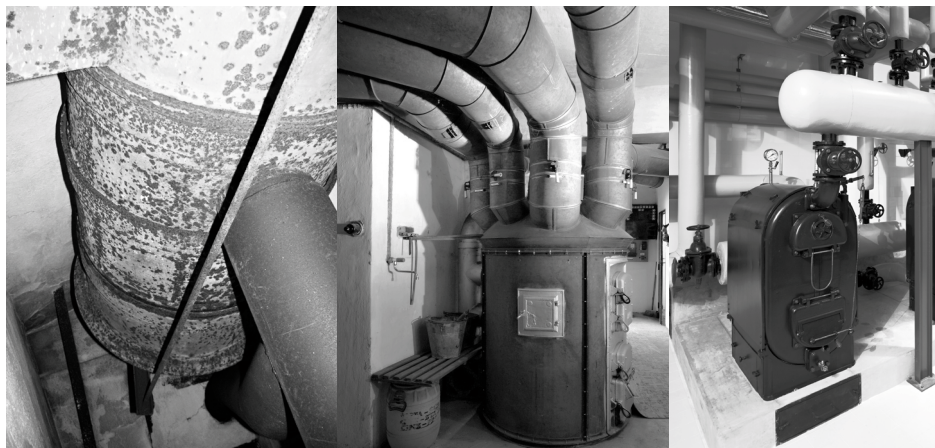
Obr. 6 Zleva: dělová kamna na zámku Hluboká nad Vltavou (foto Václav Holásek); kotel na koks s výměníkem ve vile JUDr. Eduarda Lisky ve Slezské Ostravě (foto Antonín Dvořák / SPOK); kotel na koks ve vile Tugendhat v Brně (foto vila Tugendhat, David Židlický)
