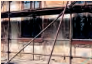
Das Erdgeschoss des SW Flügels im Jahre 2002 mit bloßgelegten Pfeilern der Arkade, Jaroměřice nad Rokytnou.
