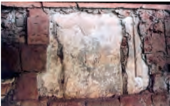
Detail dřívku pilíře arkády vnitřní strany jihozápadního křídla s pozdějšími úpravami, lištovým rámováním zúžených otvorů a následným přepletováním.
