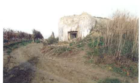
Pohled na pravou střílnu objektu LO vz. 37 A-120 ČZ (zesílena pravá strana a stropní deska). Stavební úsek 6-Mikulov, objekt č. 37, východně od Sedlece, nad vodní nádrží Nesyt.
