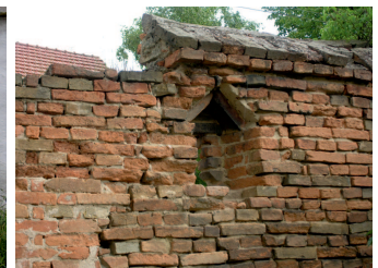
Detail autentického stavu torza hradební zdi s klíčovou střížnou, zdivo demolované vlastníkem (2008).
