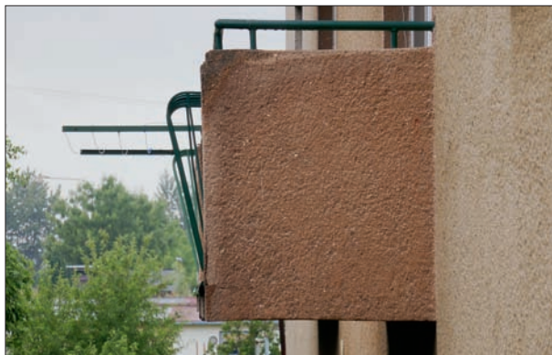
70. Originálně tvarované zábradlí je pohledově poškozeno navařenými tyčemi na sušení prádla. Uherské Hradiště. Družstevní výstavba, kombinace pískového a tmaově červeného břizolitu. 60. léta 20. století. Foto: Hana Řepková, 2021
