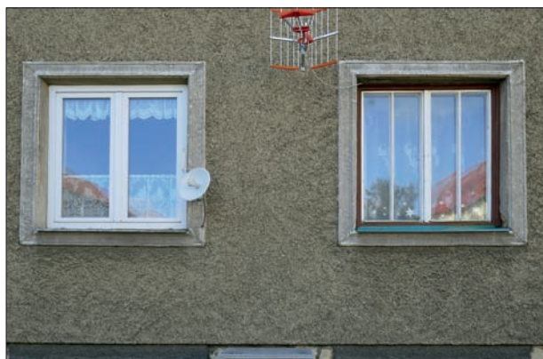
95. Ohroženým prokem fasád nechráněných souborů jsou původní okna a dveře. V mnoha souborech již zanikly beze stopy, v některých přetvořují poslední kusy. Odolena Voda, sorela, 50. léta 20. století. Dřevěná okna v barevných rámech mají nejen štíhlejší profily, ale i bohatší, a přesto moderní členění. Foto: Hana Řepková, 2021
