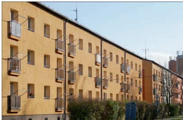
73. Sušáky jednotné konstrukce byly v rámci regenerace domu osazeny na všech balkonech. Materiálově i formátově korespondují se zábradlím, problém je orientace fasády do ulice.
