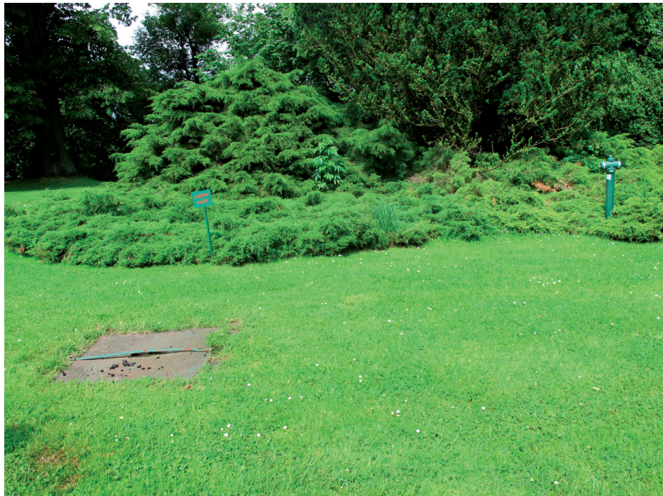
Obr. 1. Nadzemní hydrant v zahradě zámku Hradec nad Moravicí
